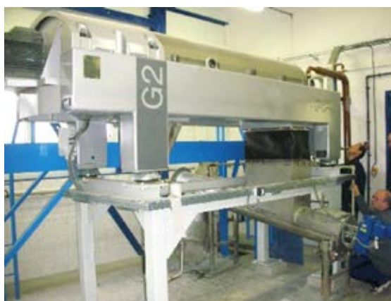
Obr. 4 Strojné odvodnenie kalu
